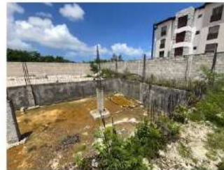
Cisterna que abastecerá el Punto GOB
