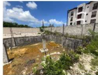
Cisterna que abastecerá el Punto GOB
